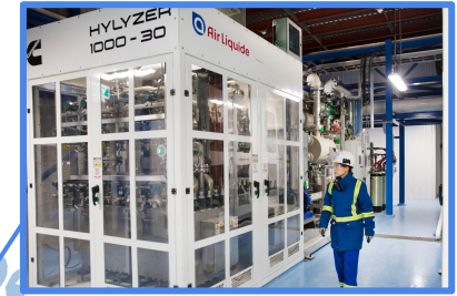
Bécancour Plus gros électrolyseur PEM en service au monde
