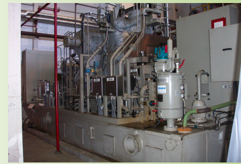
Centrale de cogénération Cornerbrook. Photo Kruger Énergie.
